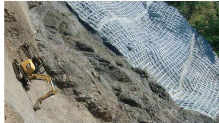
工事名称：榛原川100崩復旧治山工事 施工場所：静岡県榛原郡川根本町 発注機関：関東森林管理局大井川治山センター
