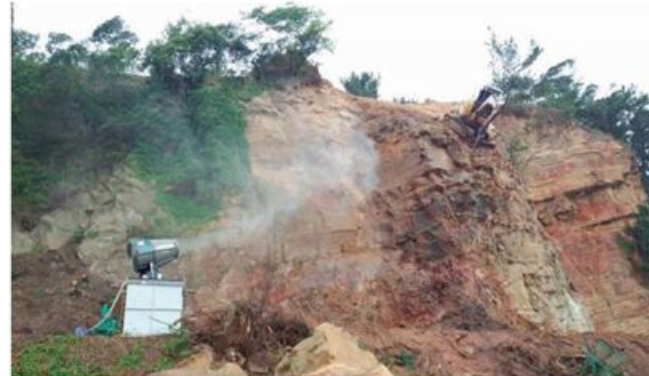
工事名称：小戸公園法面改修工事 施工場所：福岡県西区小戸2丁目地内 発注機関：福岡市
