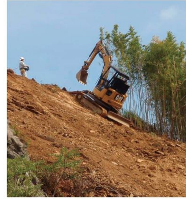
工事名称：池崎地区急傾斜地崩壊防止施設災害復旧工事 施工場所：和歌山県海南市日方地内 発注機関：和歌山県海草振興局
